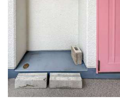
洗濯機置場(共用廊下)
