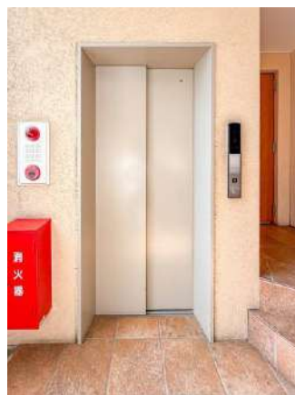
エレベーター
